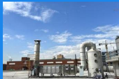
公司治理 VOCs减排装置
