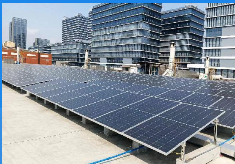
可持续发展管理 光伏发电
